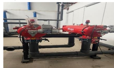
Stația de tratare
