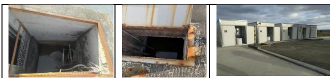
Sursă: Imagini realizate de echipa de audit în cadrul vizitelor de constatare la fața locului.
