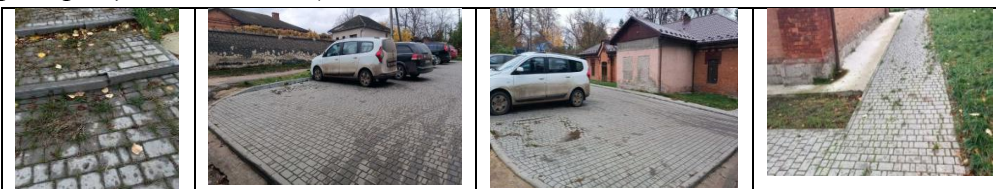
Sursă: Imagini realizate de echipa de audit în cadrul vizitelor de constatare la fața locului.
